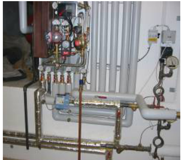
Her er alle de synlige rør til varmforsyning blevet udstyret med rørskåle af PE-skum for at isolere og holde på varmen. Billedet er fra Isover
