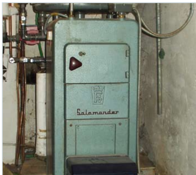
Gammelt jern, der nu er røget til genbrug - varmtvandsbeholder og Salamanderkedel. Uopslideligt, men energiteknisk forældet.
